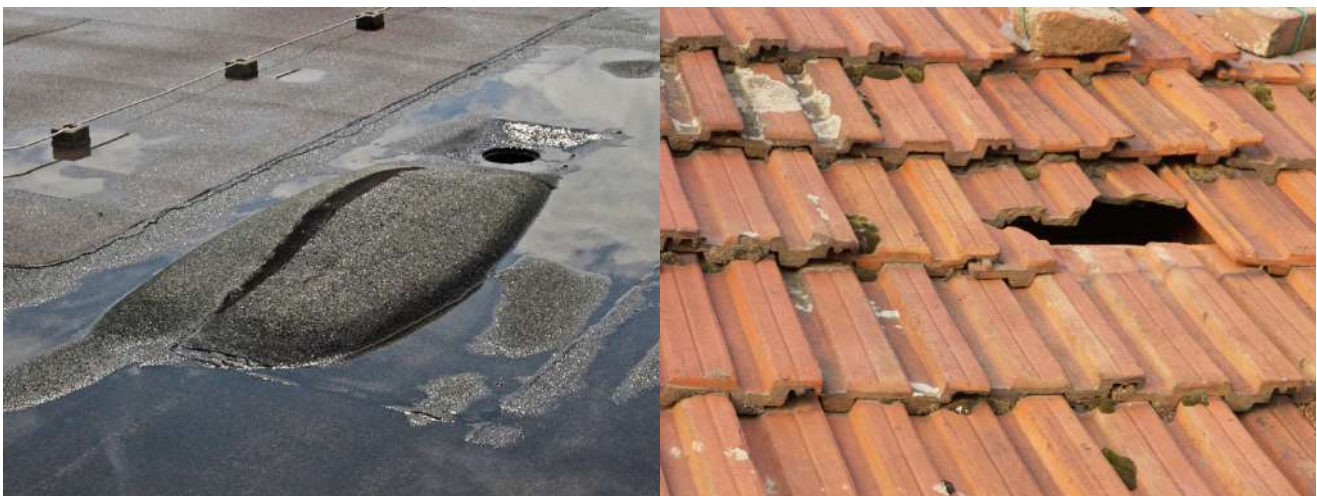
Figura 3: Daños típicos en tejados ( www.bauden.at / www.hausjournal.at )
