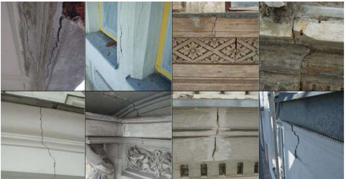
Figura 2: Daños típicos en fachadas ( https://www.zukunft-bau.at/bauschadensberichte )
