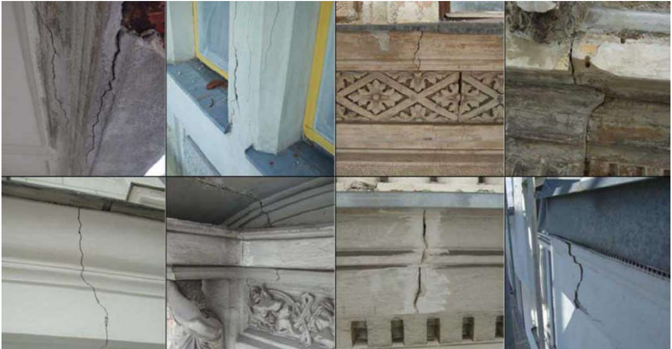
Abbildung 2: Typische Schäden an Fassaden ( https://www.zukunft-bau.at/bauschadensberichte )
