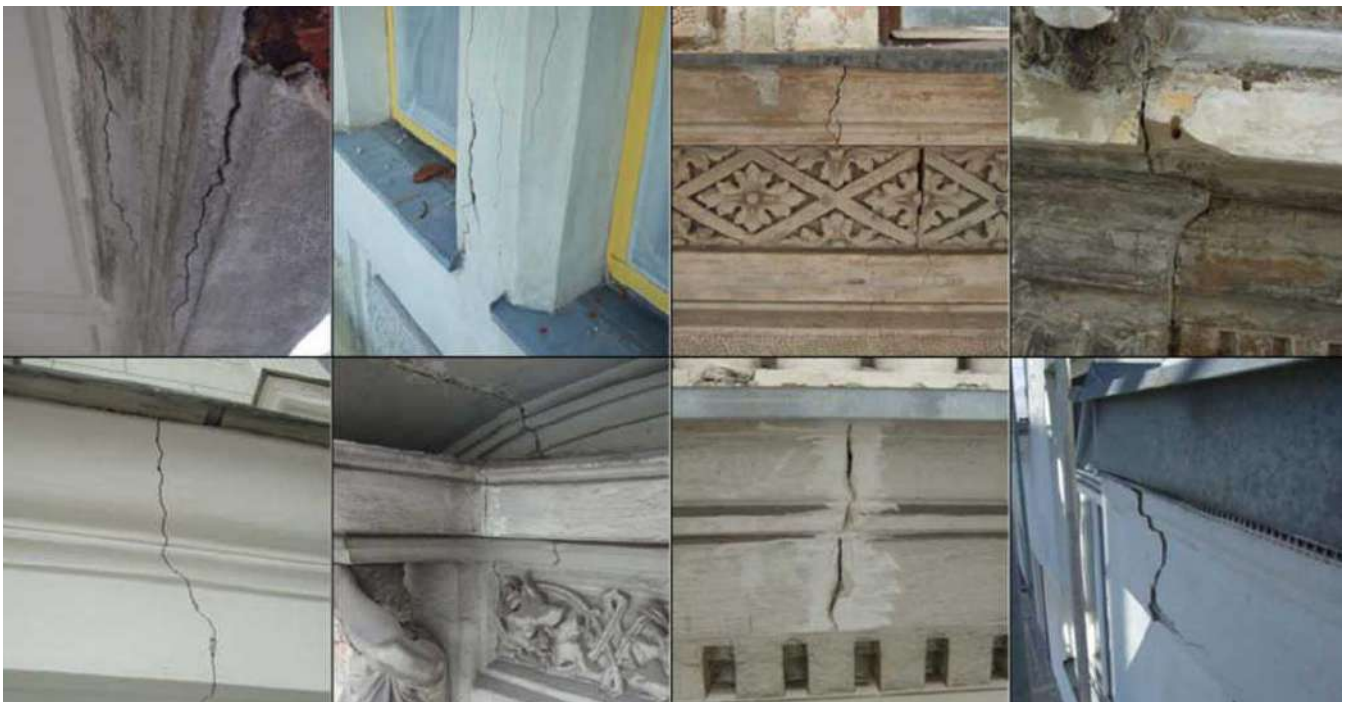
Figura 2: Daños típicos en fachadas ( https://www.zukunft-bau.at/bauschadensberichte )
