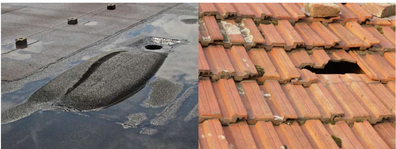
Figura 3: Daños típicos en tejados ( www.bauder.at / www.hausjournal.at )
